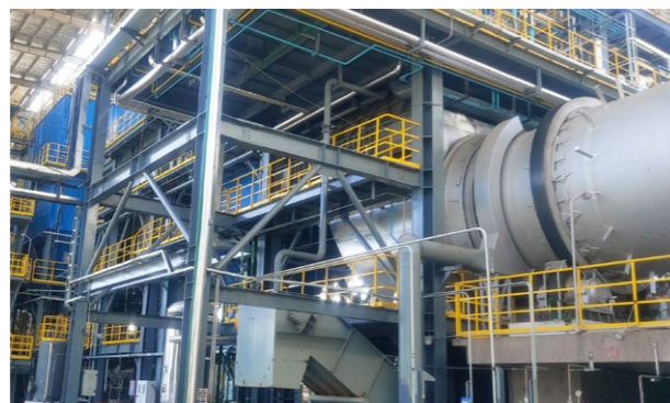
扬农瑞泰危废焚烧炉装置
