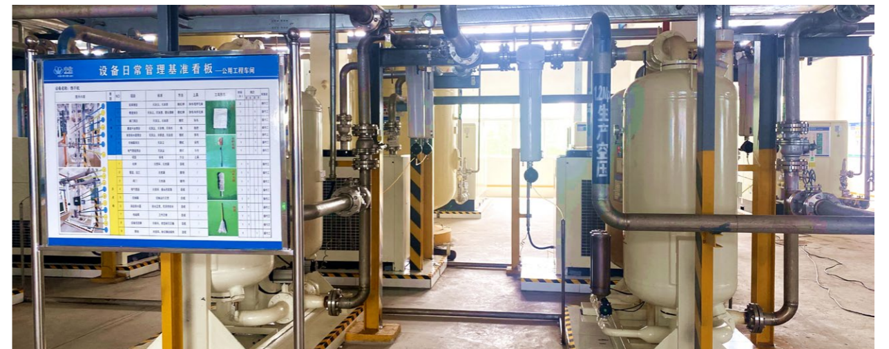
中化高纤公用工程合并节能项目改造后的空压系统
