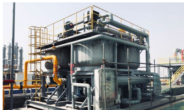
扬农瑞恒三氯苯尾气树脂吸附装置
